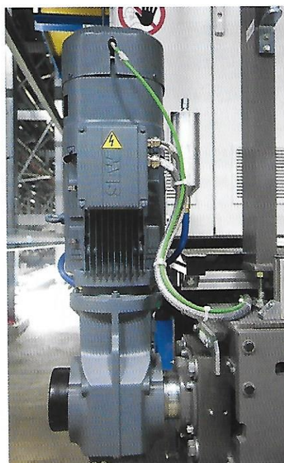
In Summe hielten 195 Antriebe von SEW-Eurodrive in das Hochregallager der Hawle-Österreich-Gruppe Einzug, 175 für die Fördertechnik.
